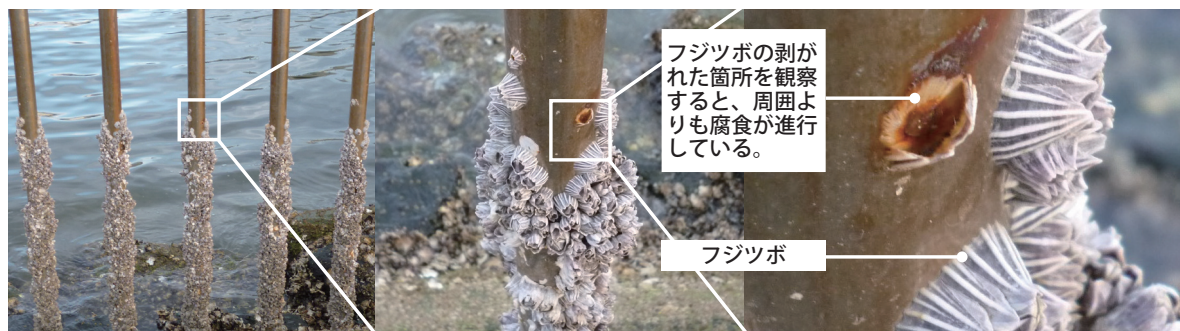
写真3 海洋生物の付着によるすき間腐食
